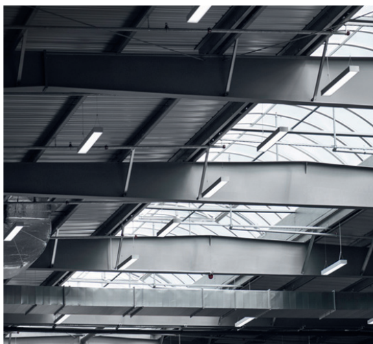
OŚWIETLENIE HAL PRZEMYSŁOWYCH
